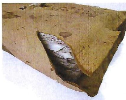
ANTES DE LA INTERVENCIÓN. CUBIERTA. ALTERACIONES. SUCIEDAD Y FALTA DE SOPORTE
